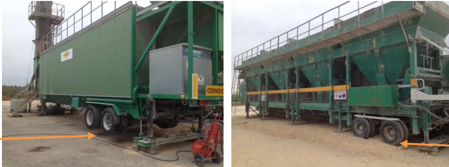
L'élévateur à raclette, la trémie de stockage des enrobés fabriqués et la citerne de fioul lourd
